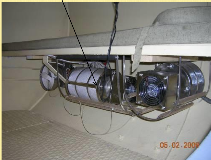
Размещение агрегатов внутри отсеков барокамеры (в каждом отсеке)
